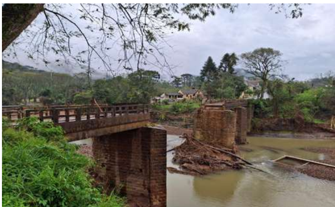
Figura 1 - Ponte construída em 1966 e destruída pela força das águas no desastre de 2024.
